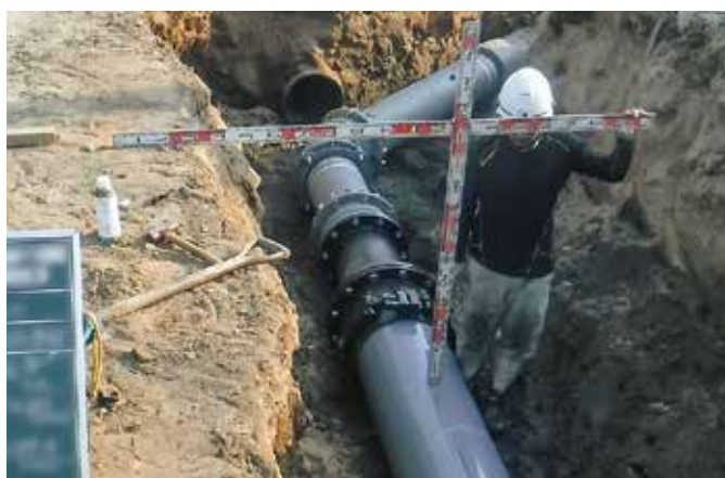
農業用水パイプラインでの使用
