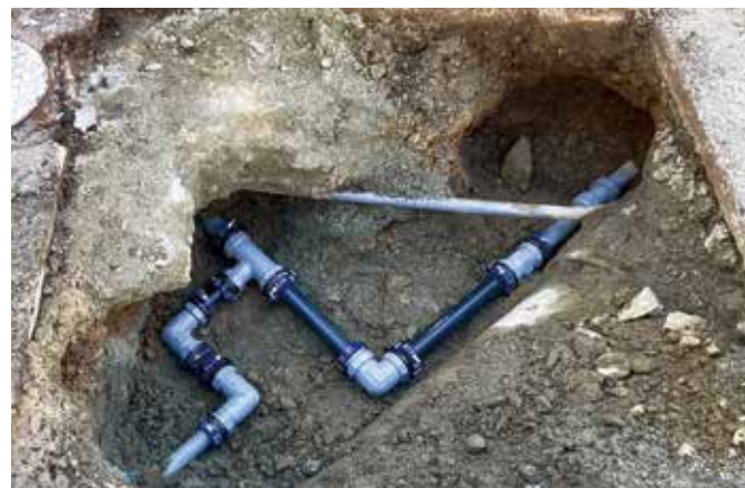
給水管路での使用
