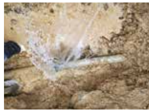
老朽管の破損による漏水
