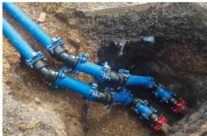
配水管路での使用
