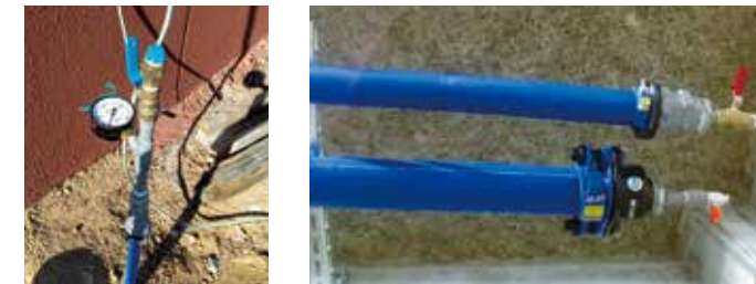
屋外：共同水栓部での使用例
